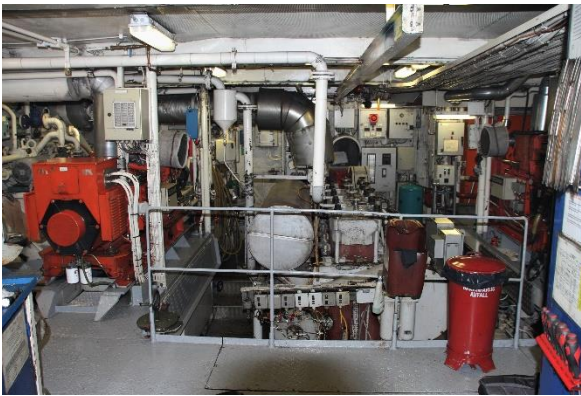
Oversikt over maskinrommet.
